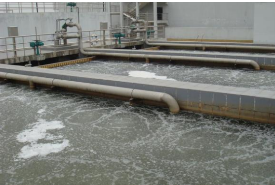
图 D：运行中的曝气生物滤池
